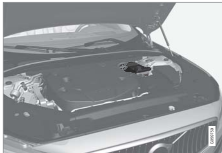
12V 補助バッテリーはストラットタワーの横のボックス内にあります。
