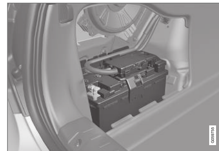
Startbatteriet befinder sig i bagagerummet.
