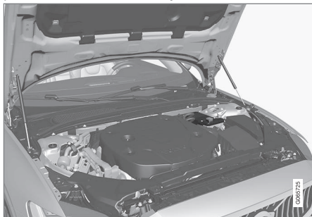
12 V podporná batéria je umiestnená v motorovom priestore.
