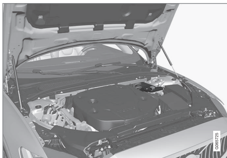
12 V stödbatteriet är placerat i motorrummet.
