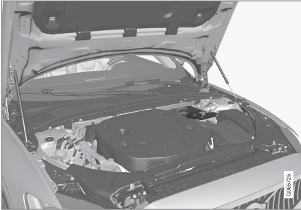
Вспомогательный аккумулятор 12 В установлен в моторном отсеке.
